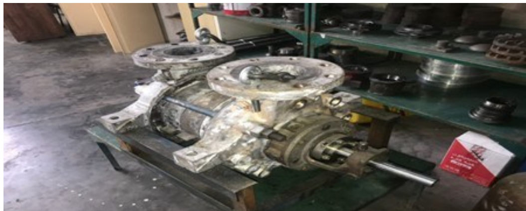
شکل ۱: پمپ آبداغ فرسوده MML100/4 تروشیا ژاپنی
