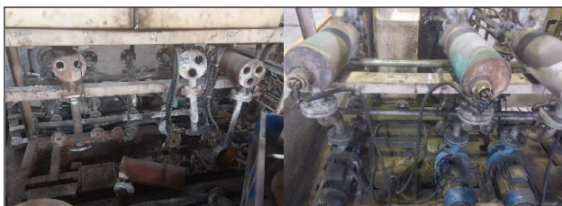
شکل ۱- سیستم کنترل دمای قدیمی اکسترودر
