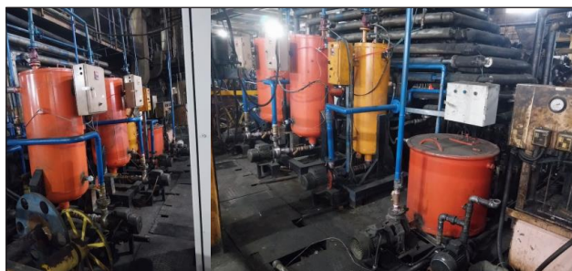
شکل ۲- سیستم کنترل دما (TCU) جدید نصب و راه اندازی شده
